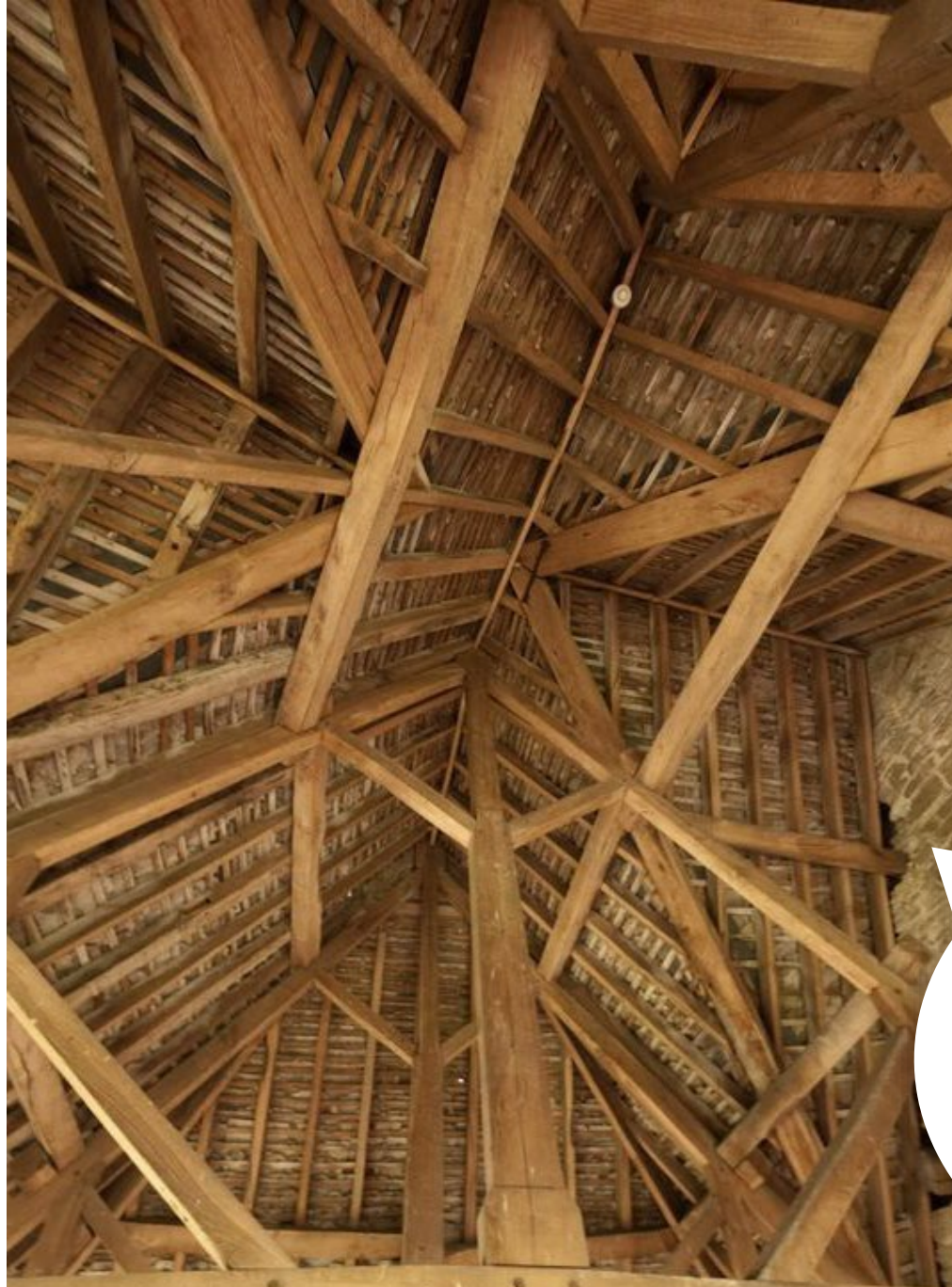
Șarpantă de lemn
